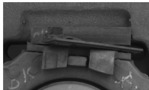
(c) Pad danificado.
